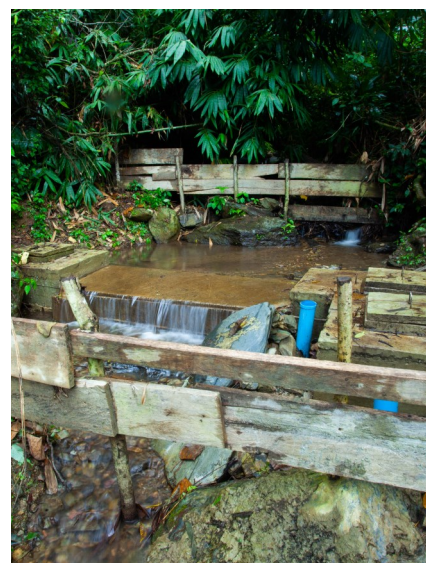
Captage d'eau dans le village de Houypha, district de Phonxay
